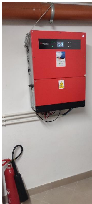
Falownik umiejscowiony w budynku Akademii – jego dokładna lokalizacja została przedstawiona na planach obiektu
